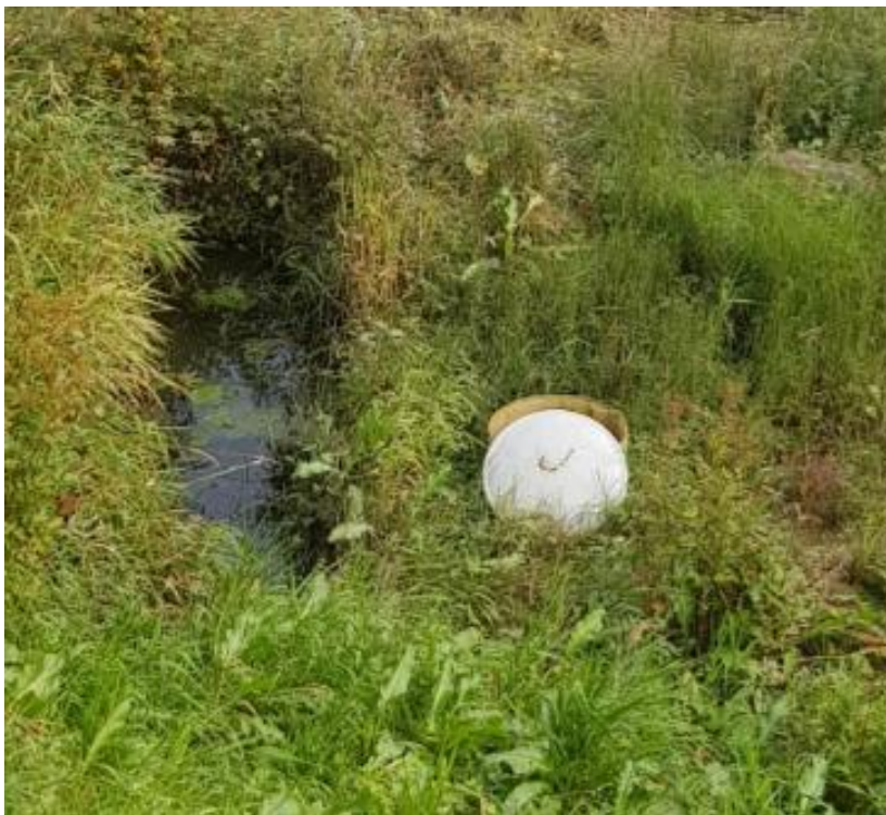
Figur 11 Kartlegging og tilsyn av spredte avløp kan i mange tilfeller avsløre avløpsanlegg som ikke tilfredsstillers dagens krav. Denne septiktanken ligger for lavt i terrenget og oversvømmes ved hver flo og fungerer dermed ikke som den skal. Foto: Rolf Pettersen.
