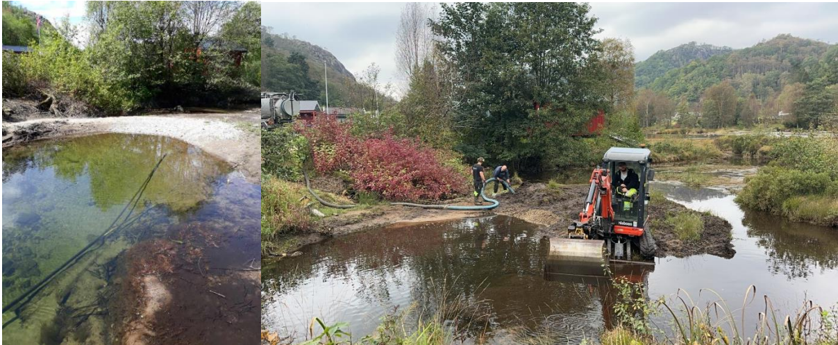
Figur 17: Til venstre vises en situasjon før tiltaket, hvor lav vannføring hindrer konnektivitet i Sirebekken. Til høyre ser vi arbeidet med å fjerne disse massene for å gjenopprette vannstrømmen. Foto: Trine S. Røyneberg.
